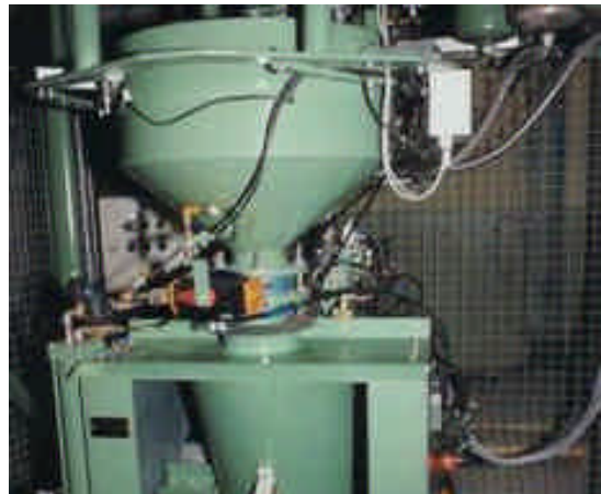
Abb. 4: PKM Mischer mit Wägebehälter zur Rohmaterialdosierung
